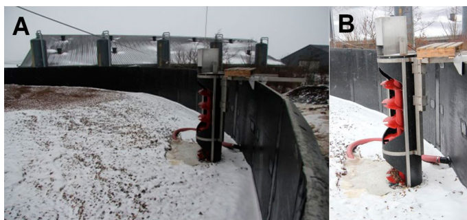
Billede 2a og 2b. Centrifugalpumpe monteret i lagertanken med knuste roer. Pumpen kan hæves og sænkes, således at der kan pumpes fra forskellige lag. Foto: Grøngas.
